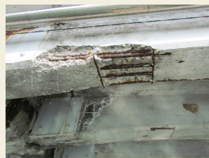
コンクリート桁の鉄筋露出
