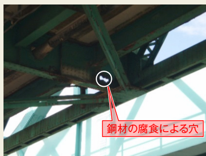
見上げれば欠損
